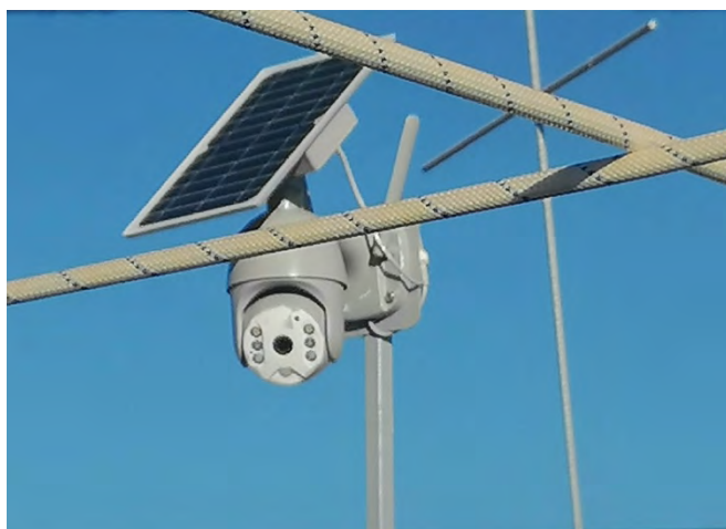
Foto 9 – Cámara de video-vigilancia instalada en el edificio-primillar. Fuente: DEMA.
